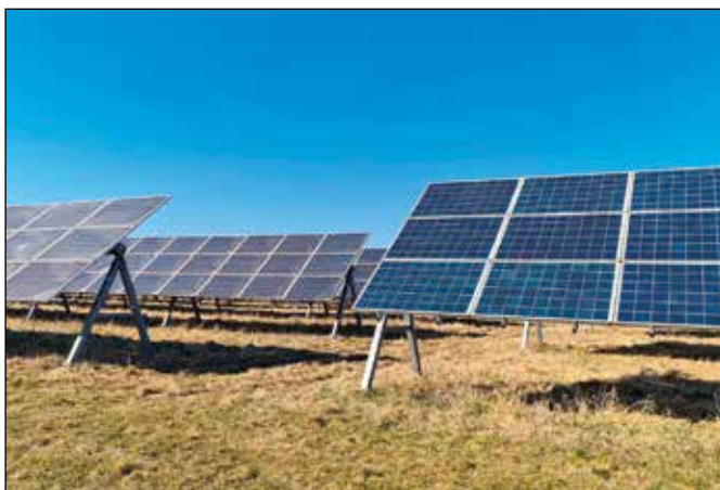
Obr. 8 Fotovoltaická elektrárna v České republice s automatickými pohyblivými stojany, rotační osy orientované vodorovně ve směru sever-jih
