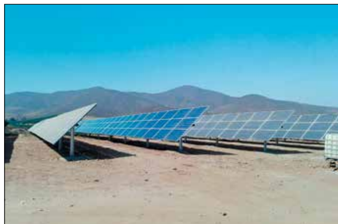
Obr. 7 Fotovoltaická elektrárna v Chile s automatickými pohyblivými stojany, rotační osy orientované vodorovně ve směru sever-jih
