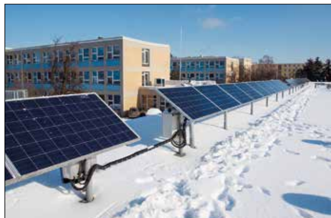
Obr. 5 Fotovoltaická elektrárna s pevnými stojany fotovoltaických panelů na střeše Technické fakulty ČZU v Praze
