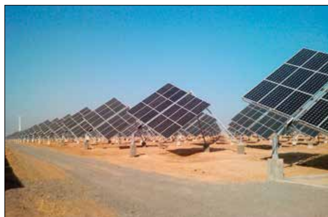
Obr. 4 Fotovoltaická elektrárna s pohyblivými stojany typu TRAXLE v Číně
